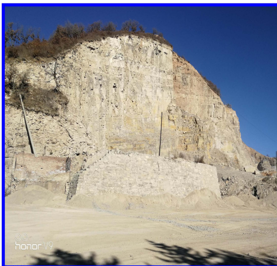
照片 BW1 不稳定边坡
