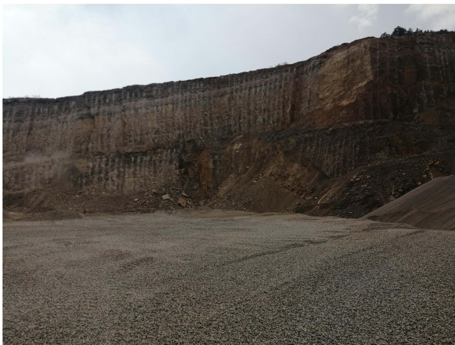
照片 1 BW1 不稳定边坡
