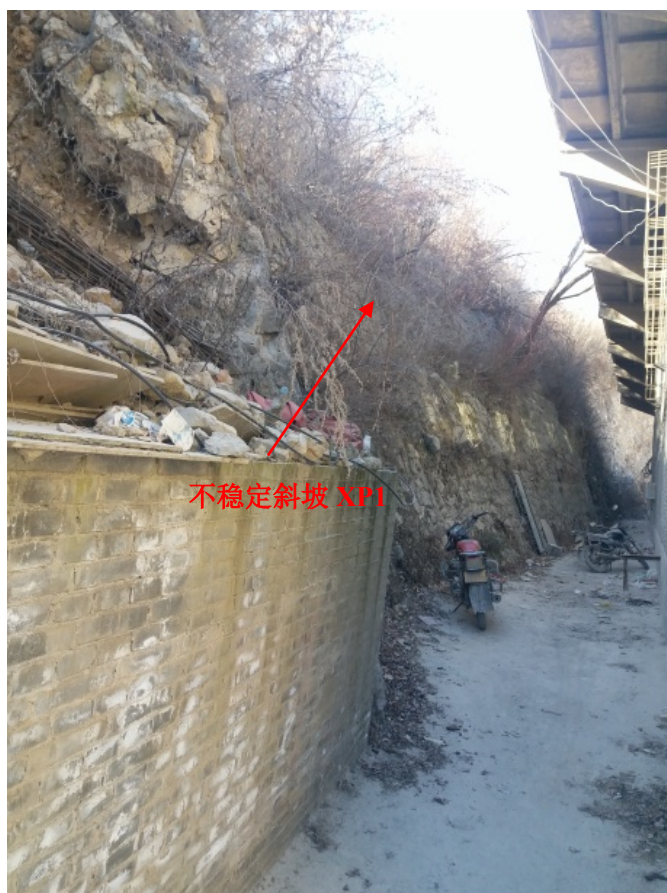
照片 8-2-2 不稳定斜坡 XP1（镜像南）
