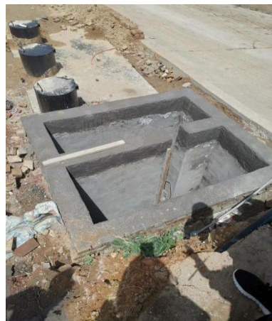
照片 8-2-29 地埋调节池
