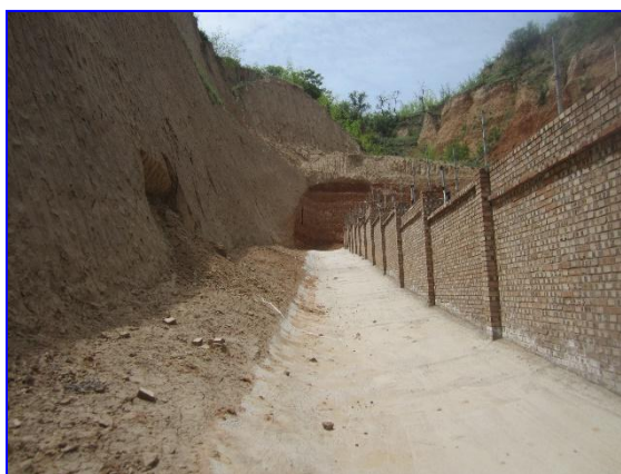
照片 8-2-13 W4 不稳定边坡(镜向 NW)
