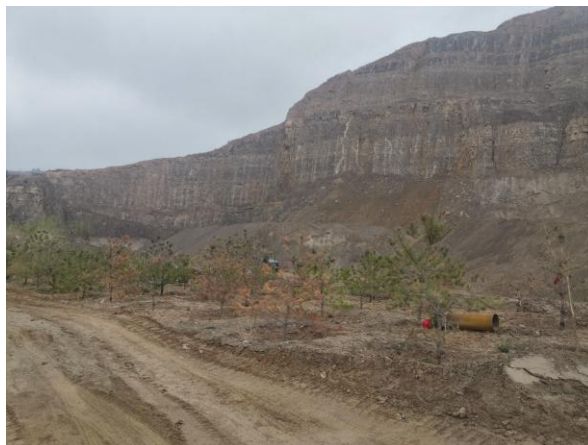
照片8-2-2 BW1不稳定边坡（镜向E）
