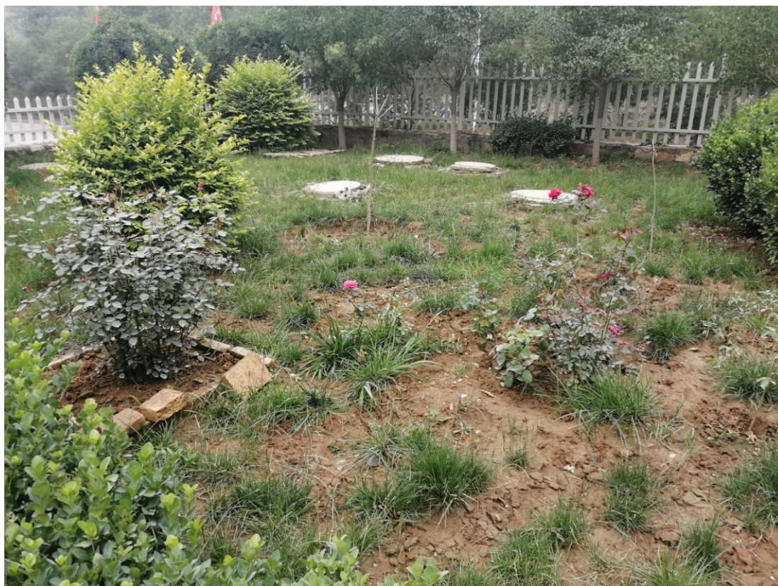
照片 8-2-22 生活污水处理站
