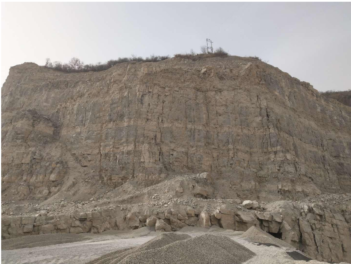
照片 1 XP1 不稳定斜坡
