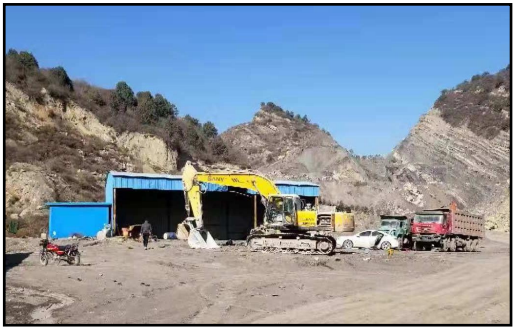
照片 2 BW2 不稳定边坡
