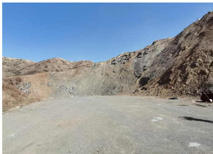
照片 8-2-1 BW1 不稳定边坡照片
