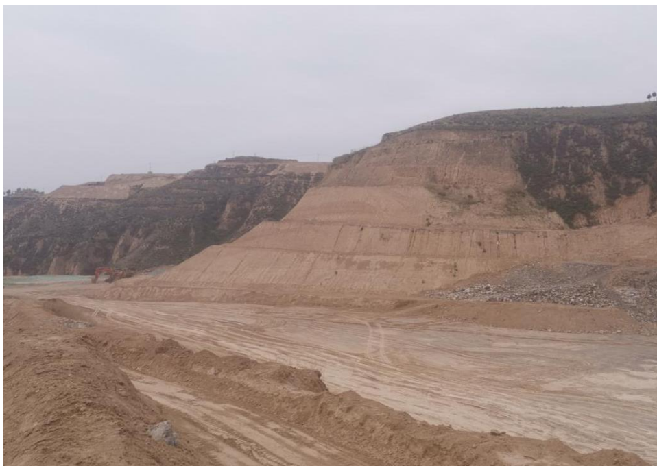
照片 8-2-2 不稳定斜坡（BP2）
