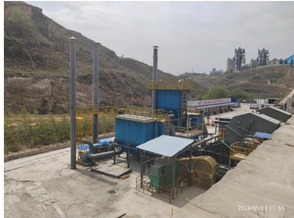
照片 8-2-16 破碎环节除尘器
