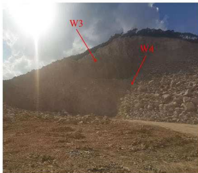
不稳定斜坡 W3、W4
