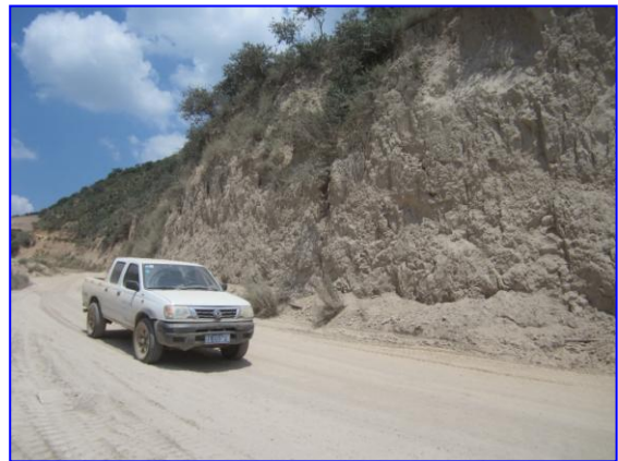
照片8-2-2 W 2 不稳定边坡（镜向NW）
